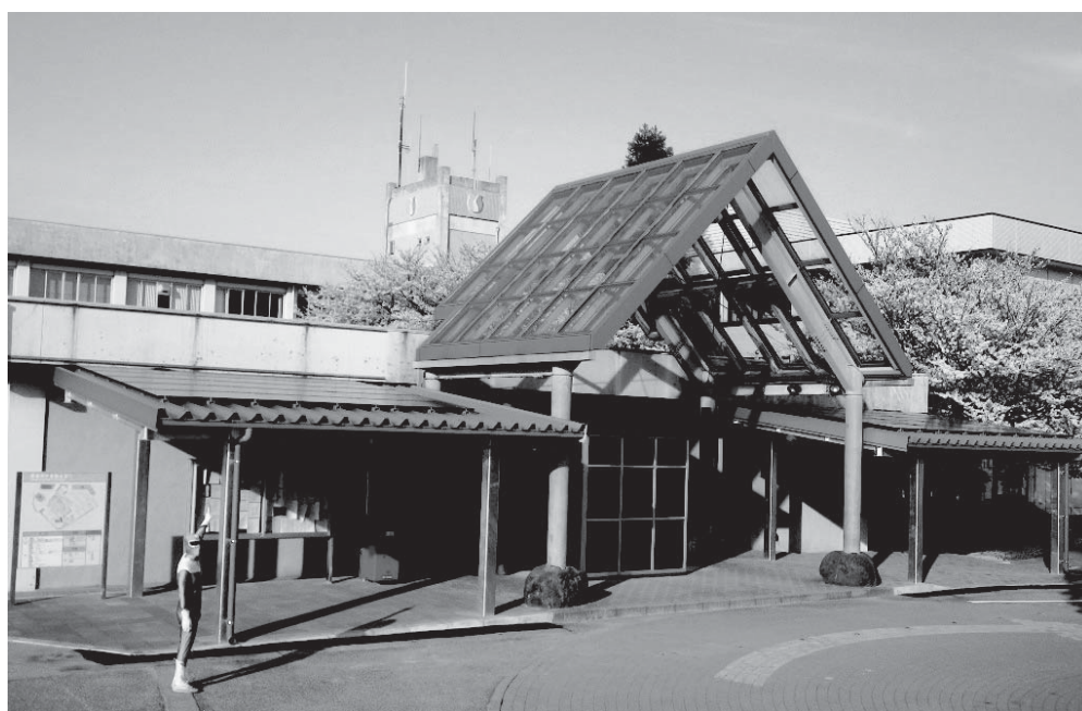
砺波市役所南側エントランスの太陽光発電システム(最大出力7.5kw)
