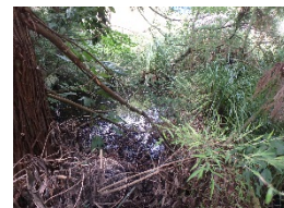
荒廃した農業用ため池
